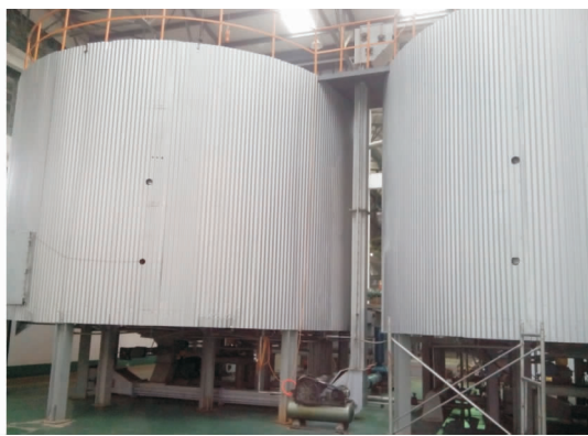
图 2 餐厨垃圾立式好氧发酵罐现场图
