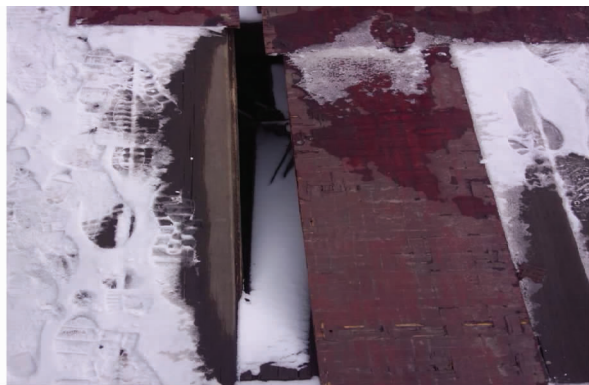
图 2 雪天路面损坏
