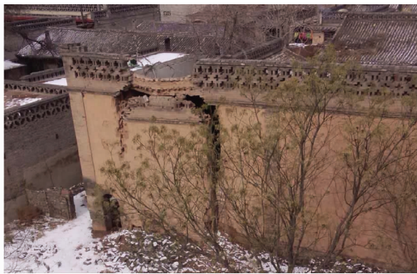
图 3 损坏的文物建筑
